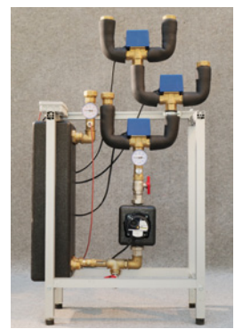
Einbindung über einen Wärmetauscher.
